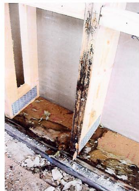
Bild 2: Mikrobiell påväxt orsakad av höga fukttillstånd i oventilerad vägg med putsad cellplastisolering.
