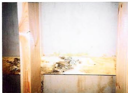
Bild 1: Mikrobiell påväxt på regelverk orsakad av högt fukttillstånd i väggen till följd av fukt som läckte in under bygget.
